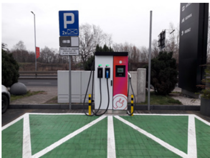
Fot. 4. Stacja ładowania DC 50 kW. Fot. SPIE
