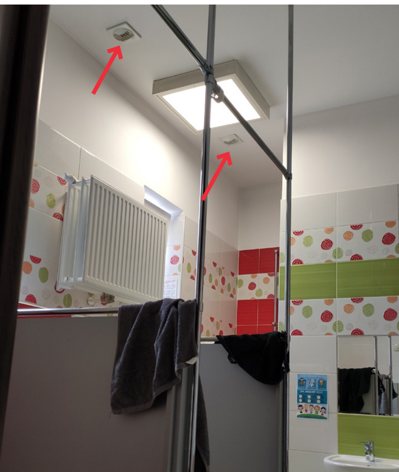
Fot. 4. Wentylacja w łazience dzieci – instalacja wyciągowa
