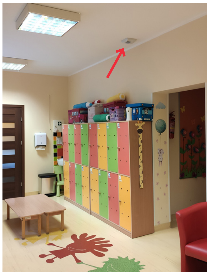
Fot. 3. Wentylacja w szatni – instalacja wyciągowa
