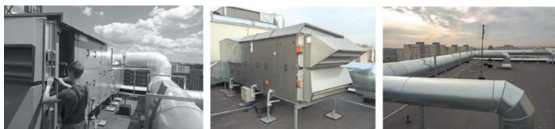
Fot. 1. Centrala nawiewno-wywiewna z odzyskiem ciepła na dachach budynków spółdzielni w Sosnowcu
