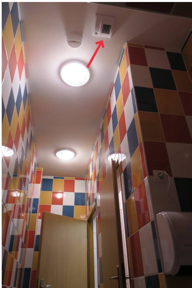
Fot. 7. Toalety – instalacja wyciągowa
