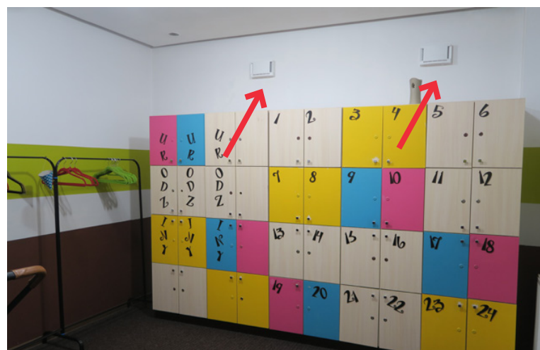
Fot. 6. Szatnia – nawiewniki ścienne
