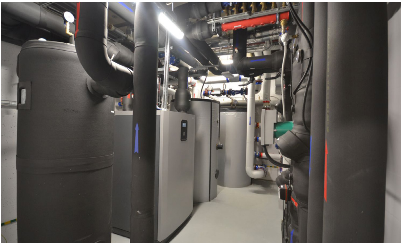
Przyszłość instalacji grzewczych – układy oparte o pompy ciepła (na zdjęciu inwerterowe pompy gruntowe). Fot. Thermia
