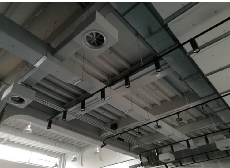
Przykład realizacji systemu wentylacyjnego URSA AIR
