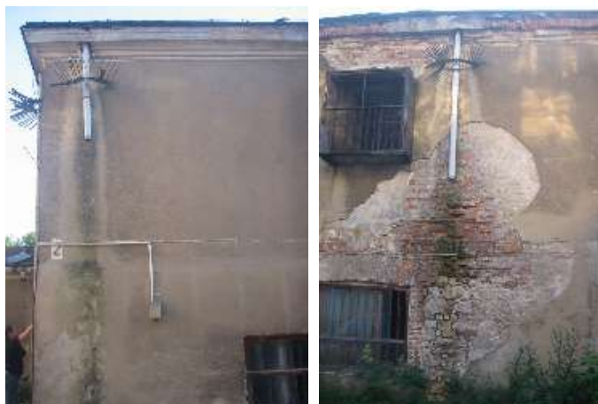
Fot. 1. Zdjęcia archiwalne (2007 r.). Stan techniczny skrzydła wschodniego: a) narożnik płn-zach., b) elewacja wschodnia.
