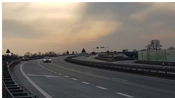
Fot. 1. Przykład węzła na drodze ekspresowej klasy S, na którym brak jest oświetlenia drogowego, niespełniający wymagań § 109 Rozporządzenia Ministra Transportu i Gospodarki Morskiej z dnia 2 marca 1999 r. w sprawie warunków technicznych, jakim powinny odpowiadać drogi publiczne i ich usytuowanie (Dz.U. z 1999 r., nr 43, poz. 430 z późniejszymi zmianami)
